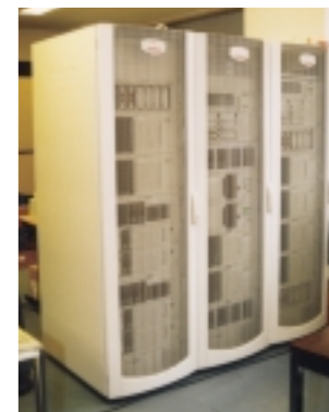
De redundantie van de ProLiant CL1850 servers en de Compaq oplossing in het algemeen beantwoordde perfect aan de verwachtingen.
